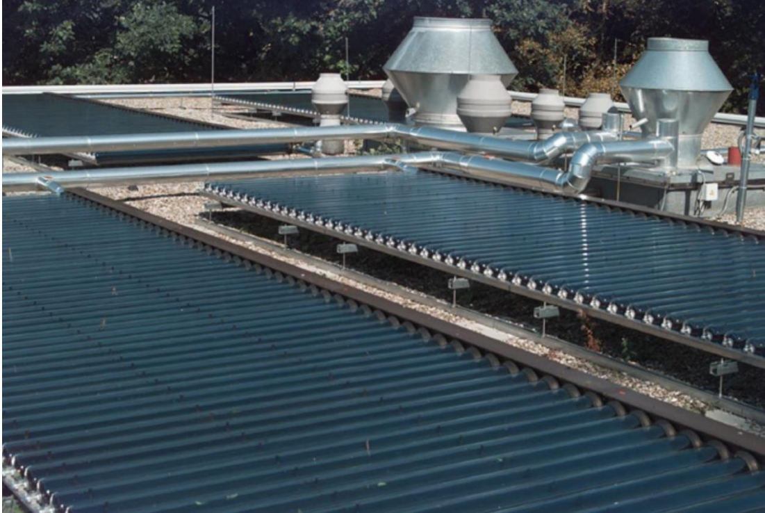
Εικόνα 2.9: Συλλέκτες κενού στο Πανεπιστημιακό Νοσοκομείο του Freiburg. [30]
