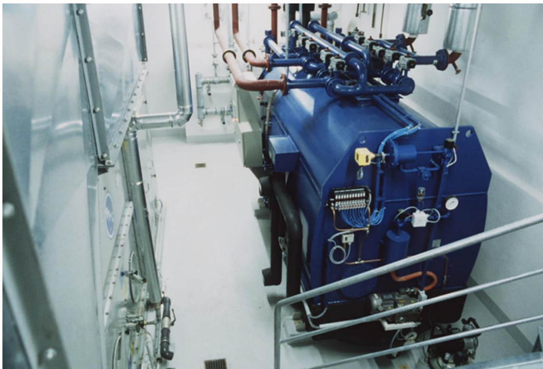
Εικόνα 2.8: Ψύκτης προσρόφησης στο Πανεπιστημιακό Νοσοκομείο του Freiburg. [30]
