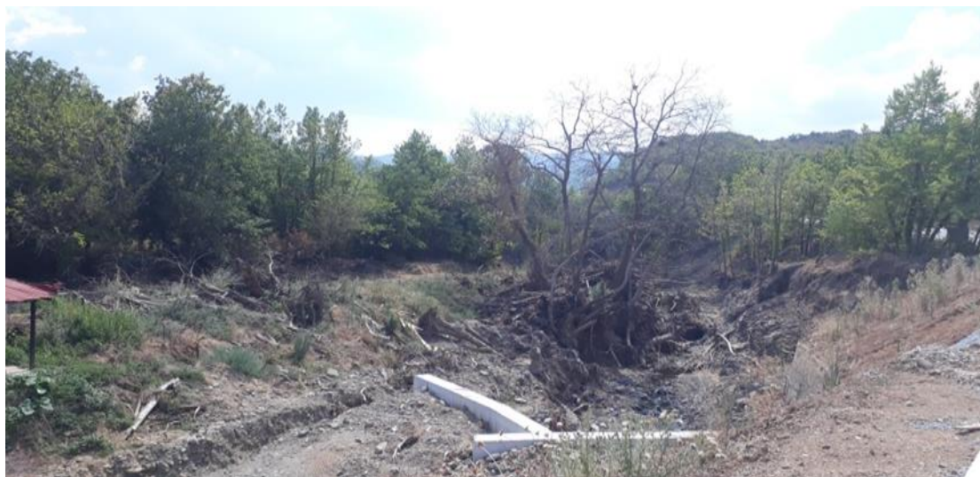
Εικόνα 39. Καταστροφές από τον Ιανό στην επαρχιακή οδό Καλλιθήρου – Νεράιδας (φωτ. αρχείο Ν. Γιαννούλα)
