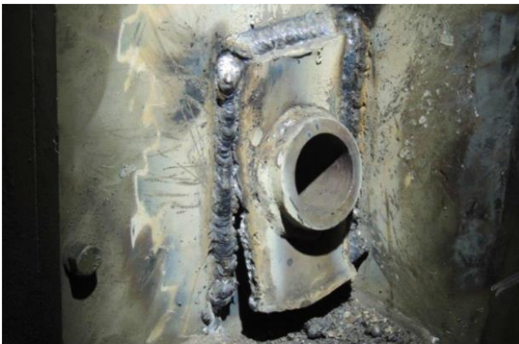
Εικόνα 2.8.2 – Η φλάντζα μετά την αστοχία
