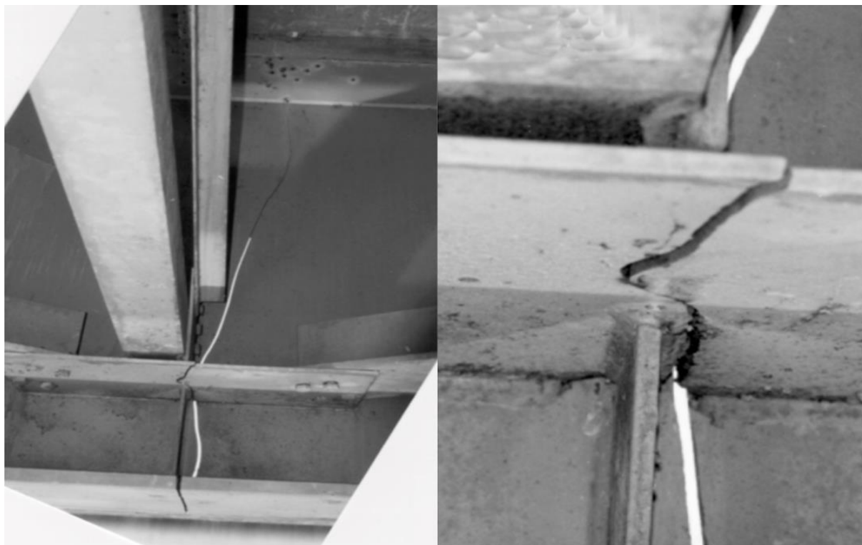
Εικόνα 2.3.1 – Η ρωγμή που παρατηρήθηκε
