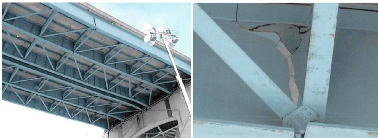
Εικόνα 2.6.1 – Η ρωγμή που παρατηρήθηκε στη γέφυρα Χόαν
