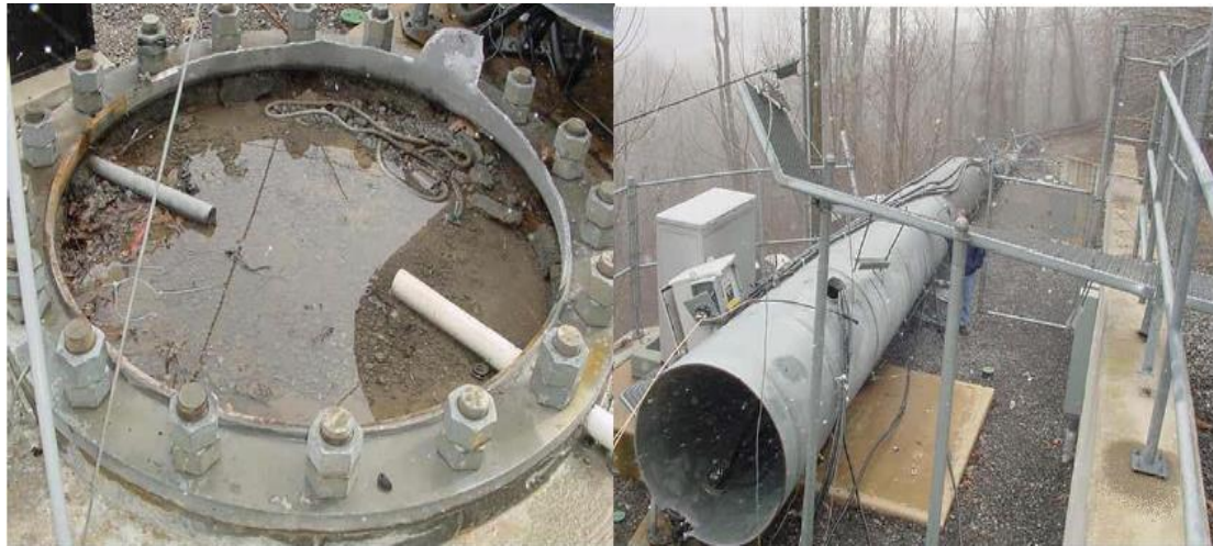
Εικόνα 2.7 Αστοχία κεραίας τηλεπικοινωνιών λόγω κόπωσης (Eng., Giosan, 2005).
