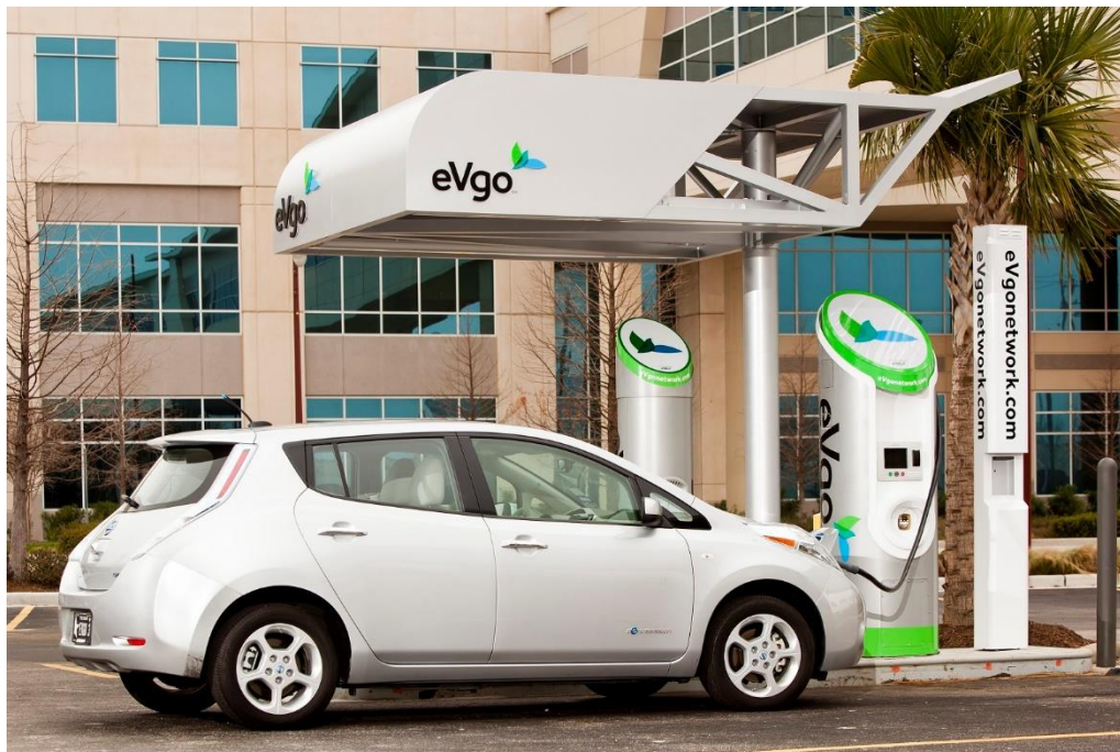
Εικόνα 10. Σταθμός φόρτισης ηλεκτρικού αυτοκινήτου. Πηγή: (Moloughney, 2013)
