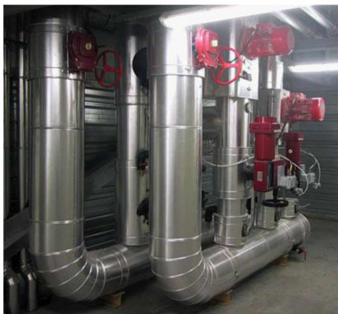
Εικόνα 2.1: Θερμομόνωση δικτύου ατμού
