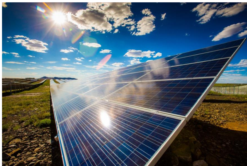
Εικόνα 2.2: Συστοιχία φωτοβολταϊκών πλαισίων. [11]
