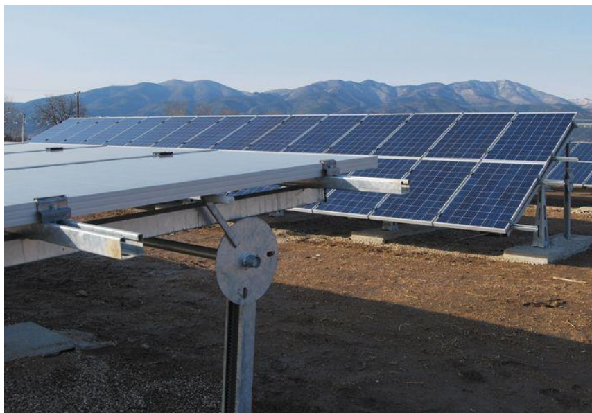
Εικόνα 4.5: Στήριξη φωτοβολταϊκών πλαισίων με δυνατότητα εποχικής ρύθμισης.
