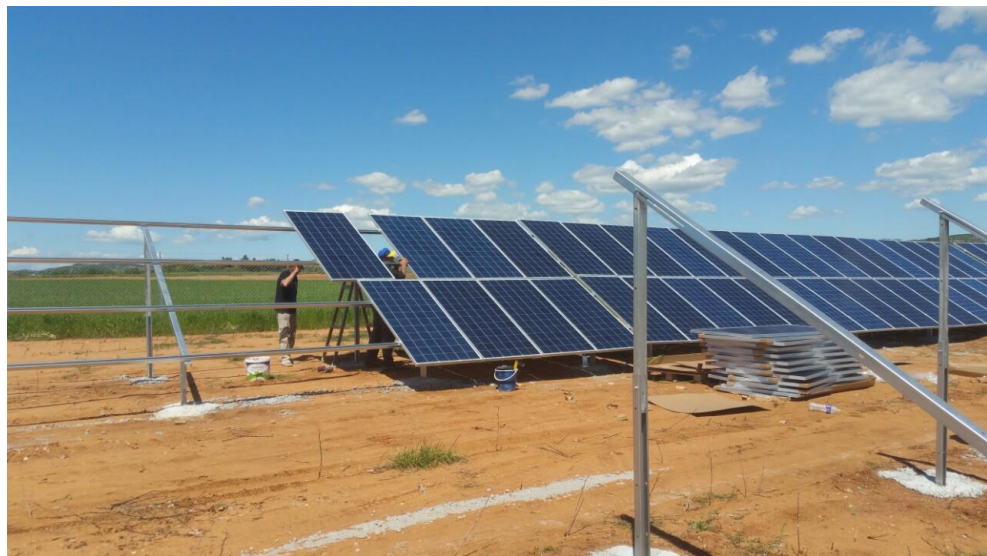
Εικόνα 4.4: Σταθερή βάση στήριξης φωτοβολταϊκών πλαισίων.
