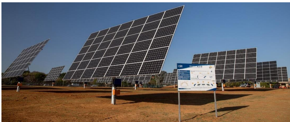
Εικόνα 4.6: Στήριξη φωτοβολταϊκών πλαισίων τύπου tracker.
