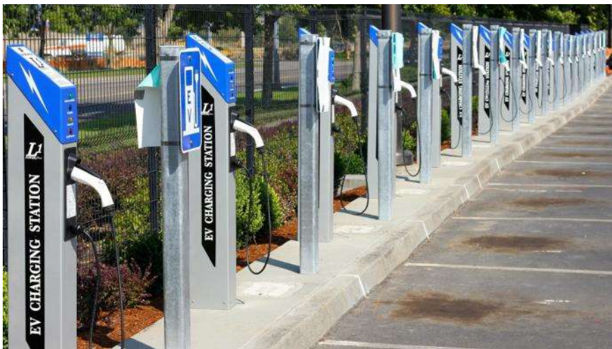
Εικόνα 7.2.1: Σταθμοί ηλεκτρικής φόρτισης οχημάτων
