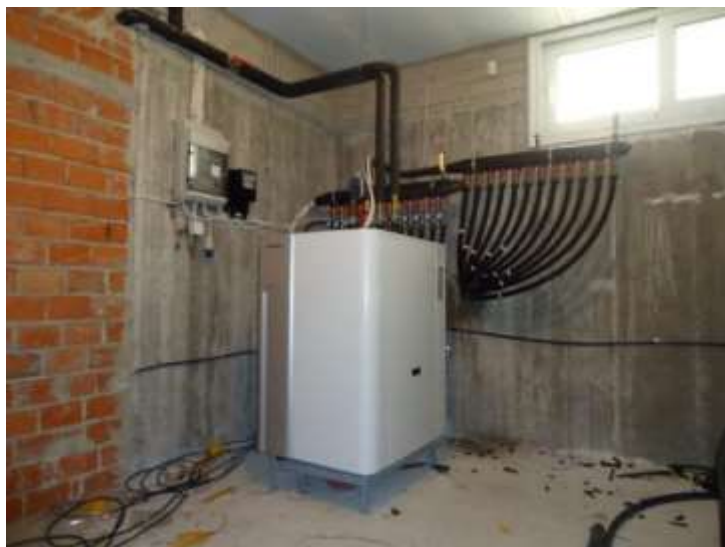
Εικόνα 7.1.6: Γεωθερμική αντλία θερμότητας
