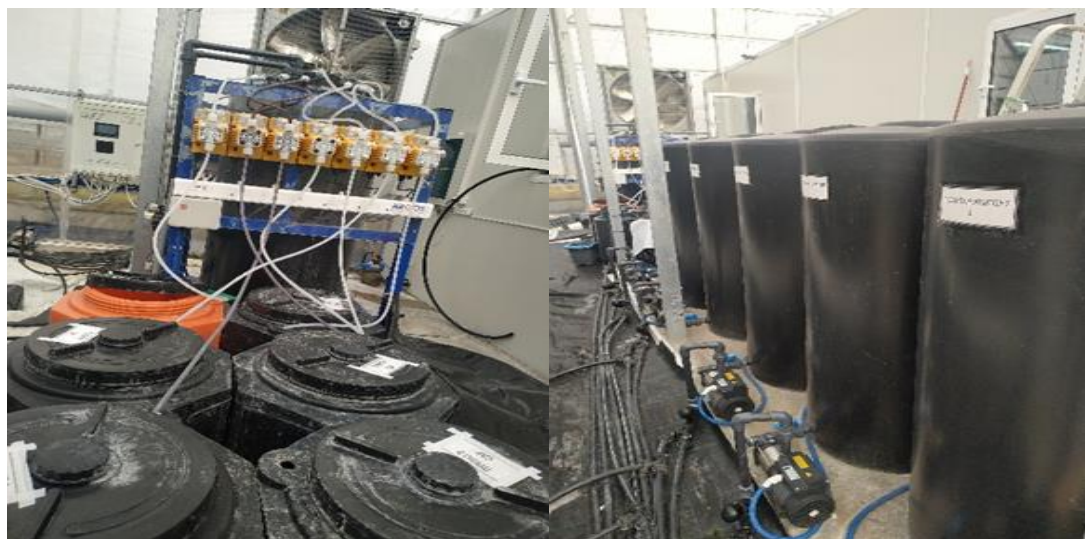
Εικόνα 10: Η κεφαλή υδρολίπανσης και δεξαμενές πυκνών διαλυμάτων (Αριστερά). Δεξαμενές αποθήκευσης θρεπτικού διαλύματος (Δεξιά).
