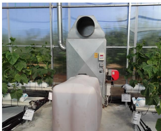
Εικόνα 7. Αερολέβητας πετρελαίου για την θέρμανση του θερμοκηπίου.
