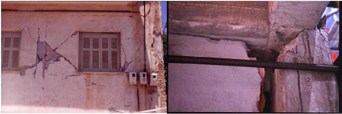
Σχήμα 1.1: Αστοχία: (α) τοιχοποιίας, (β) υποστυλώματος λόγω μεγάλης δυσκαμψίας τοιχοπληρώσεων [3]
