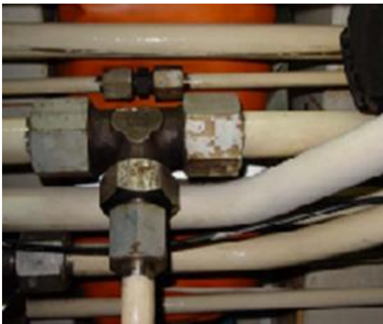
Εικόνα 2.4 (Κατασκευή που έχει υποστεί γαλβανική διάβρωση)
