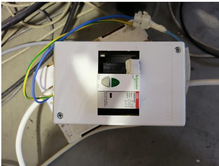
Εικόνα 3.19 (Ηλεκτρολογικό κουτί που έχουν τοποθετηθεί τα δύο ρελέ και ο διακόπτης on/off)
