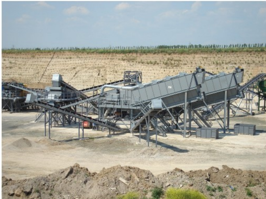
Σχήμα 2.7: Όψη μόνιμης μονάδας επεξεργασίας ΑΕΚΚ - μονάδα ανακύκλωσης αδρανών Β. Ελλάδας [2]
