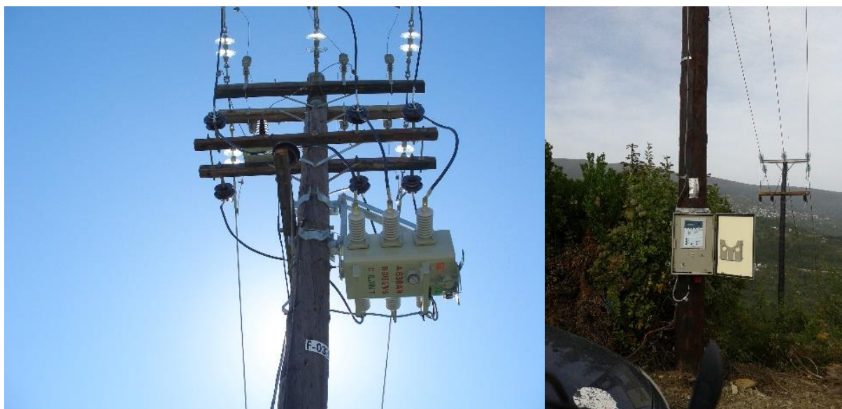
Εικόνα 1: Τηλεχειριζόμενος διακόπτης φορτίου εναερίου δικτύου αριστερά – μονάδα ελέγχου του διακόπτη στη βάση του στύλου δεξιά (πηγή ΔΕΔΔΗΕ)
