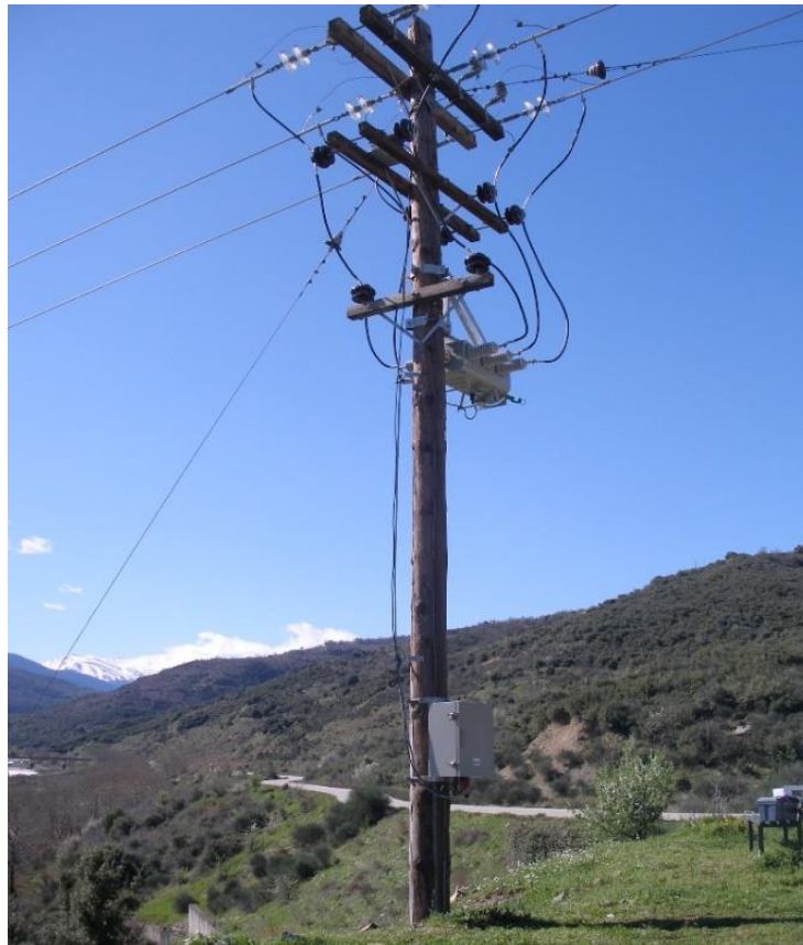
Εικόνα 6. Τηλεχειριζόμενος διακόπτης φορτίου εναερίου δικτύου εγκατεστημένος επί στύλου (Πηγή ΔΕΔΔΗΕ)
