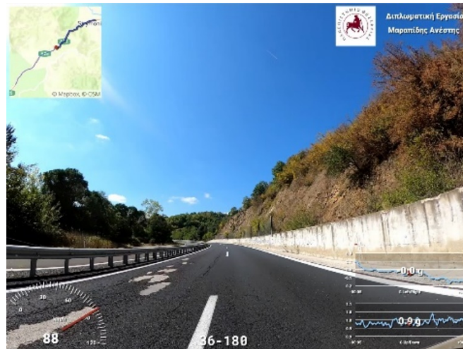
Εικόνες 5.15.1.5 Ενδεικτική θέση με φθορά στο οδόστρωμα και αποκόλλησης της αντιολισθηράς στρώσης, Χ.Θ.36+180 (Αριστερός κλάδος) (Πηγή : Προσωπικό Αρχείο)
