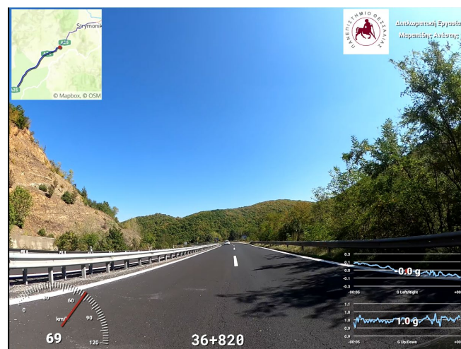
Εικόνα 5.4.1.2 Διατομή δεξιού κλάδου Χ.Θ. 36+820, Στιγμιότυπο από βιντεοσκόπηση του οδικού τμήματος (Δεξιός κλάδος) (Πηγή : Προσωπικό Αρχείο)
