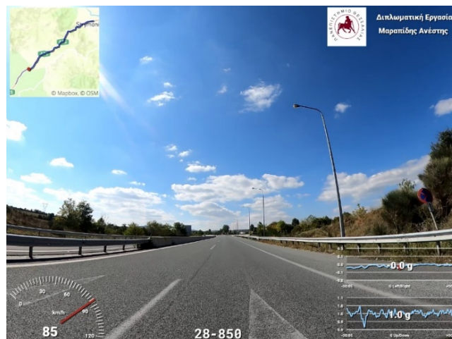
Εικόνα 5.9.3.4 Δυσκολία εντοπισμού και Ρυθμιστικής πινακίδας απαγόρευσης στάσης και στάθμευσης P40 λόγω βανδαλισμού Χ.Θ. 28+850 (Αριστερός κλάδος) (Πηγή : Προσωπικό Αρχείο)
