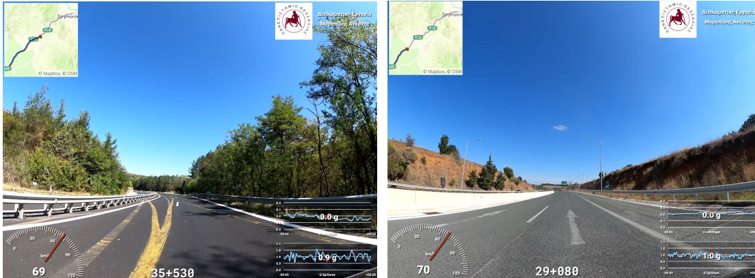
Εικόνες 5.7.3.1 και 5.7.3.2 Ενδεικτικές θέσεις εμφάνισης παλιάς διαγράμμισης Χ.Θ. 35+530 και οριζόντιας σήμανσης που απαιτεί συντήρηση Χ.Θ. 29+080 (Δεξιός κλάδος) (Πηγή : Προσωπικό Αρχείο)
