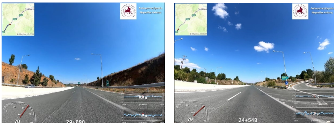
Εικόνες 5.10.1.1 και 5.10.1.2 Ενδεικτικές θέσεις φθαρμένης οριζόντιας σήμανσης που απαιτεί συντήρηση, Χ.Θ. 29+090 και Χ.Θ. 24+540 (Δεξιός κλάδος) (Πηγή : Προσωπικό Αρχείο)
