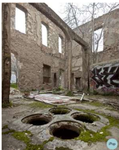
Εικόνα 16 – Τμήμα της ανατολικής πτέρυγας, στο οποίο έχει καταρρεύσει ολοσχερώς η στέγη. iPop
