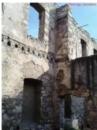
Εικόνα 14 – Τμήμα της ανατολικής πτέρυγας, στο οποίο έχει καταρρεύσει η στέγη και το πάτωμα. Tasosbmd
