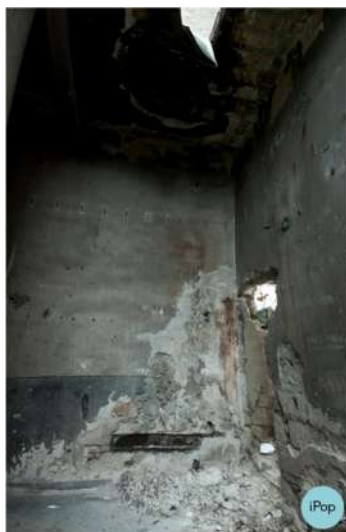
Εικόνα 17 – Εμφανή η επίδραση της υγρασίας στην τοιχοποιία του κτηρίου. iPop
