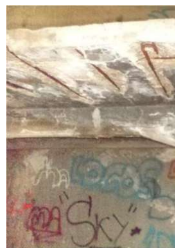
Εικόνα 13 – Οξείδωση του οπλισμού. Αστέρι, Γκαραλιάκος, Λουκούζα.
