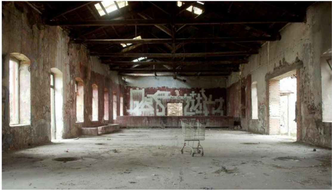
Εικόνα 23 – Εσωτερική λήψη νότιας πτέρυγας πριν την κατάρρευση της στέγης. iΡορ
