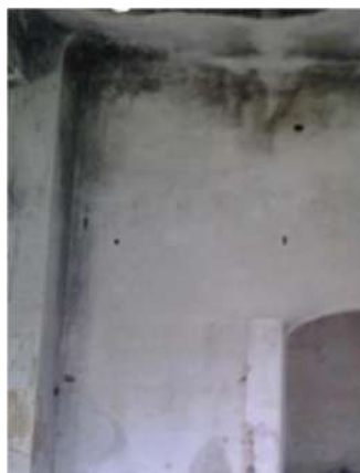
Εικόνα 15 – Εσωτερικός χώρος εργοστασίου με εμφανή τα σημάδια της μούχλας και της υγρασίας στο τοίχο και το ταβάνι. Αστέρη, Γκαραλιάκος, Λουκούζα.
