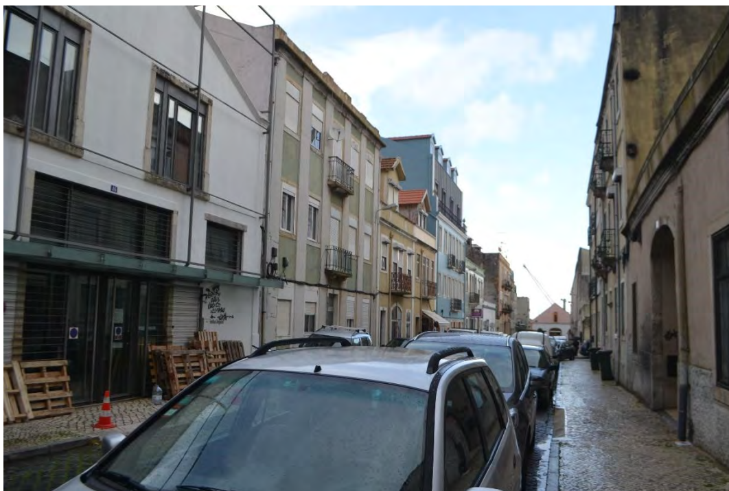
Εικόνα 53. Κτήριο υπό ανακαίνιση (πρώτο κτήριο αριστερά) στην οδό Capitão Leitão. Πηγή: προσωπικό αρχείο
