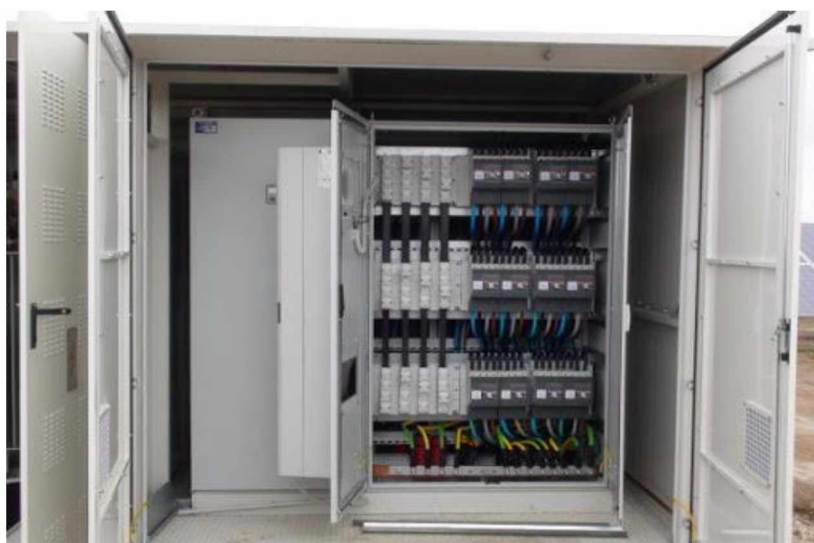
Εικόνα 3: Πίνακας χαμηλής τάσης.( http://www.nrg-orion.gr/erga51.php )
