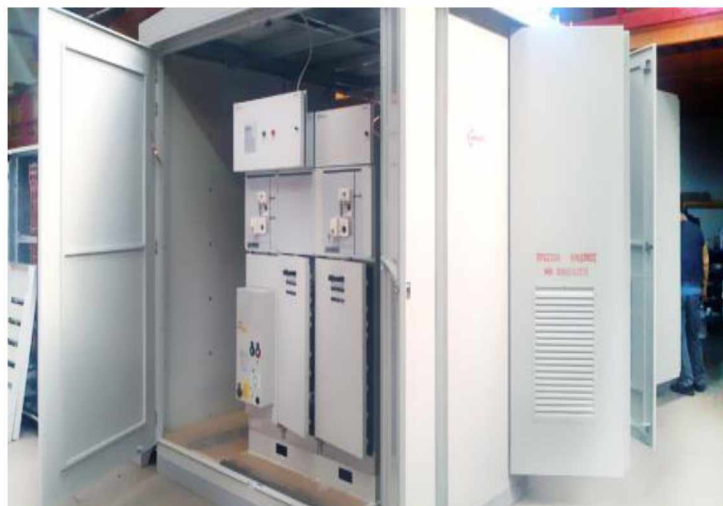
Εικόνα 1: Πίνακας μέσης τάσης. ( https://www.vimepp.gr/pinakes-mesis-tasis/ )
