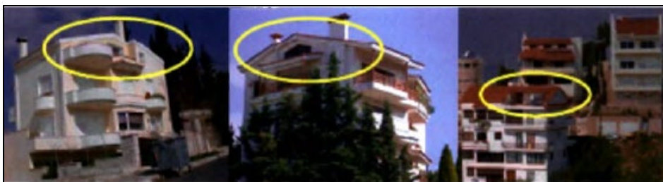
Εικόνα 4: Αυθαίρετες κατασκευές κάτω από επικλινείς στέγες (Πηγή: Σαμαράς, 2008)
