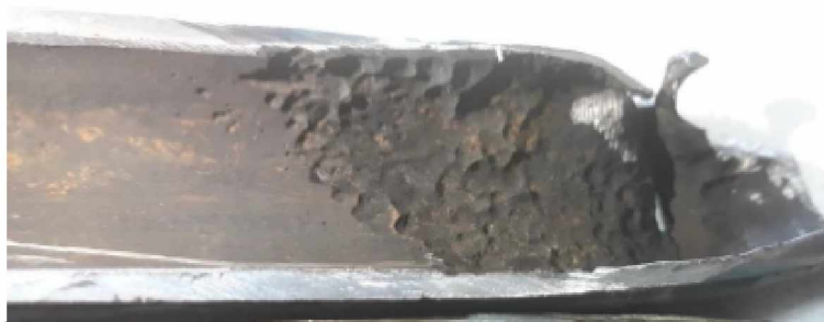
Σχήμα 4.4: Διάβρωση στην εσωτερική επιφάνεια του αιλού
