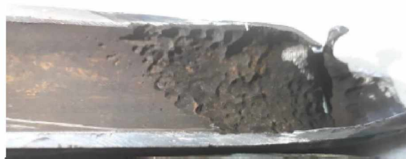
Σχήμα 1.5: Εσωτερική πλευρά σωλήνα στο σημείο διάβρωσης
