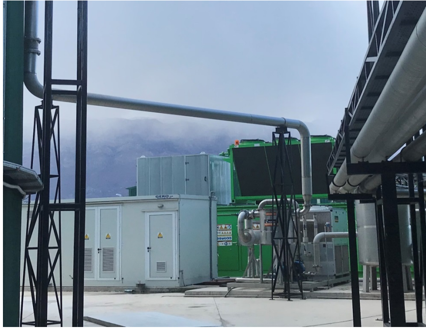
Εικόνα 34: Σύστημα ψύξης βιοαερίου
