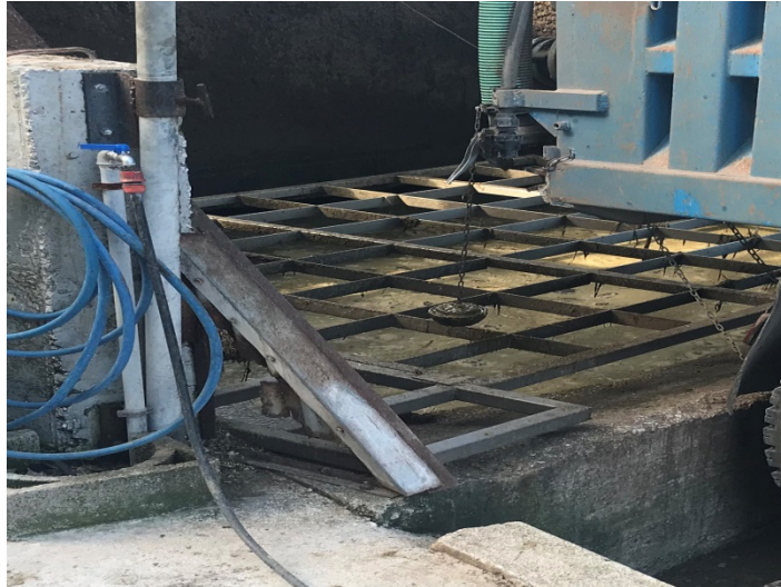
Εικόνα 36: Δεξαμενή εισαγωγής υγρών λυμάτων
