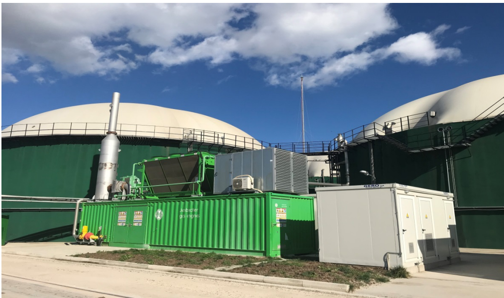
Εικόνα 32: Μονάδα βιοαερίου 1,5 MW
