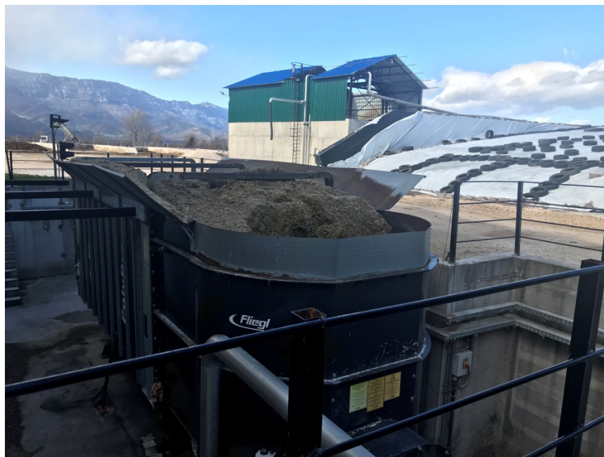
Εικόνα 35: Δεξαμενή εισαγωγής καλαμποκιού
