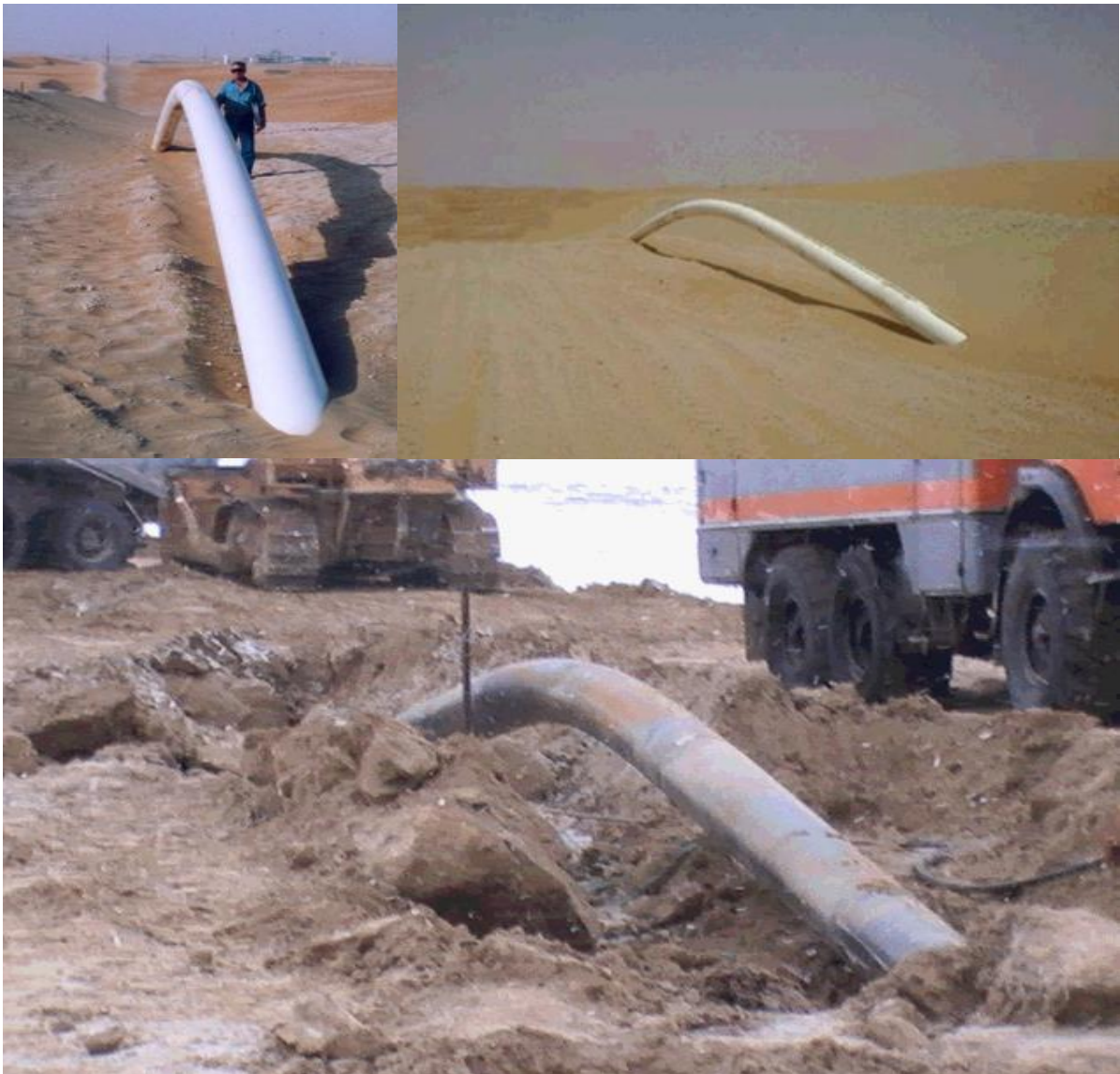
Σχήμα 2-4. Ολικός λυγισμός υπόγειων μεταλλικών αγωγών ( http://www.passuite.com )
