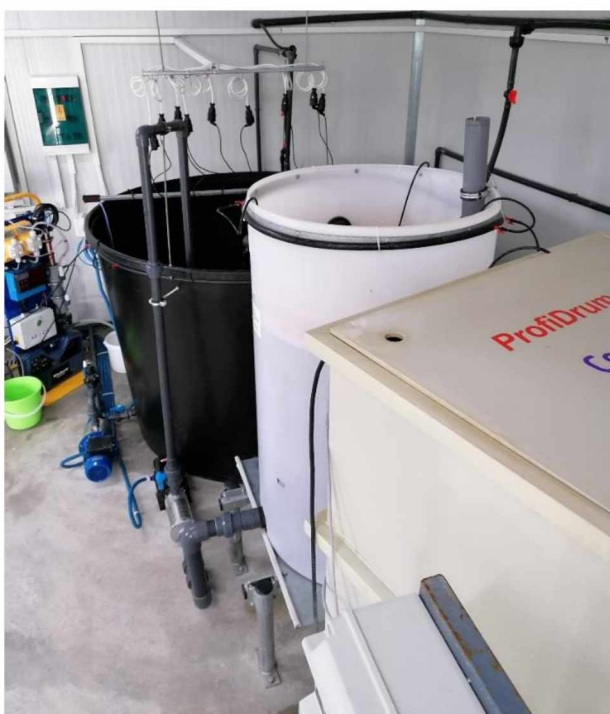
Εικόνα 3: Το σύστημα των φίλτρων στην ενυδρείοπониική εγκατάσταση. Από δεξιά προς αριστερά, α) μηχανικό-βιολογικό φίλτρο β) βιολογικό φίλτρο γ) δεξαμενή Sump Tank
