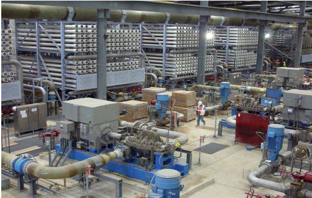
Εικόνα 1-9 Εργοστάσιο αφαλάτωσης θαλασσινού νερού στο Περθ της Αυστραλίας.
