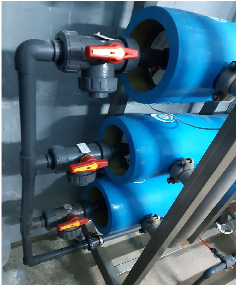
Εικόνα 5-16 Δοχεία πίεσης – Έξοδος αφαλατωμένου νερού
