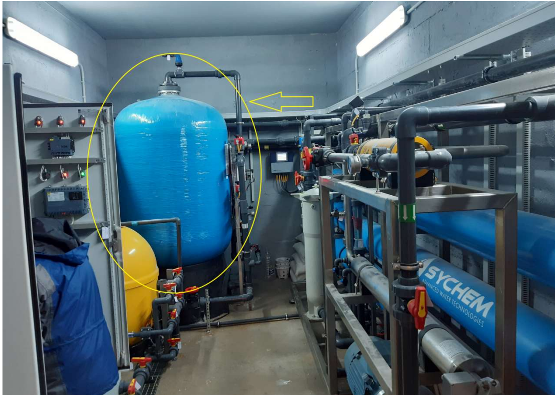
Εικόνα 5-4 Φίλτρο άμμου από την μονάδα αφαλάτωσης στο Marbella Elix
