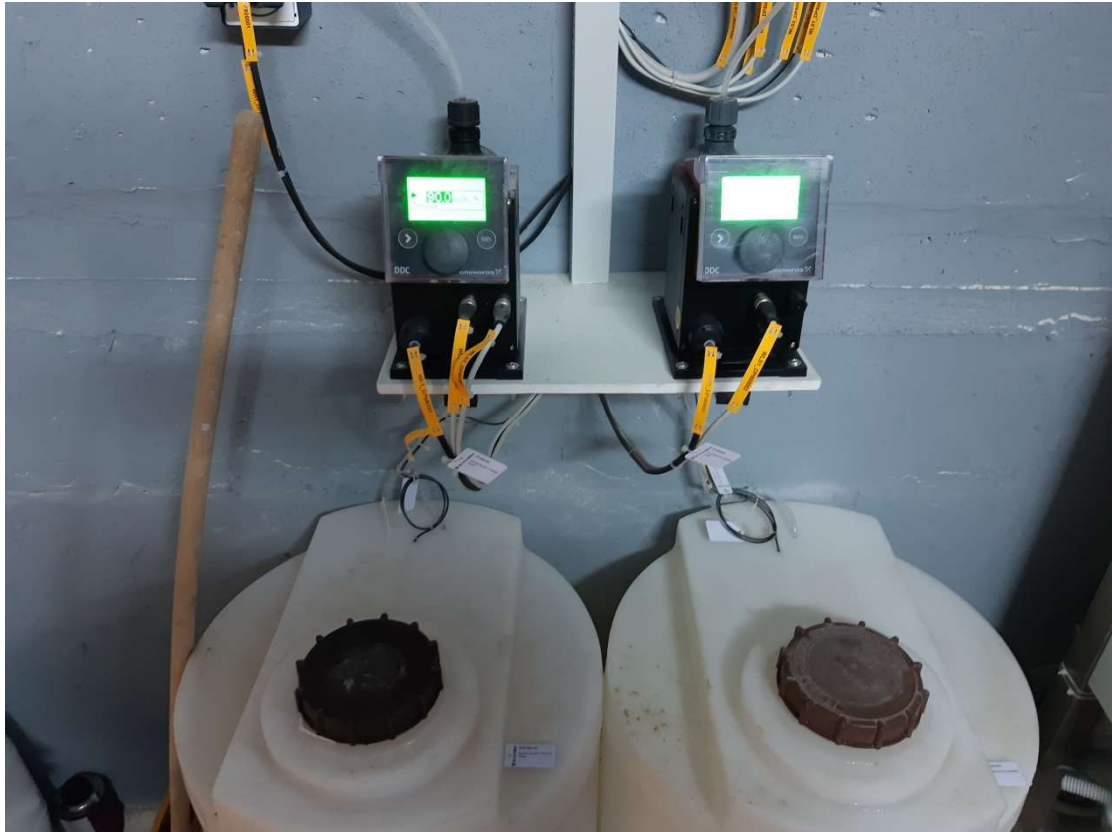
Εικόνα 5-20 Δοσομετρικές αντλίες αντικαθαλωτικού νερού και χλωρίου στην μονάδα αφαλάτωσης
