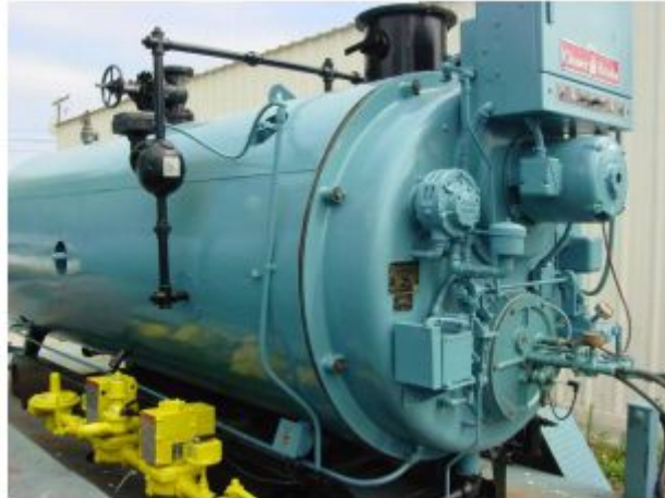
Εικόνα 16: Λέβητας ζεστού νερού φυσικό αερίου
