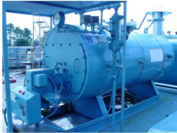
Εικόνα 17: Λέβητας ατμού πετρελαίου
