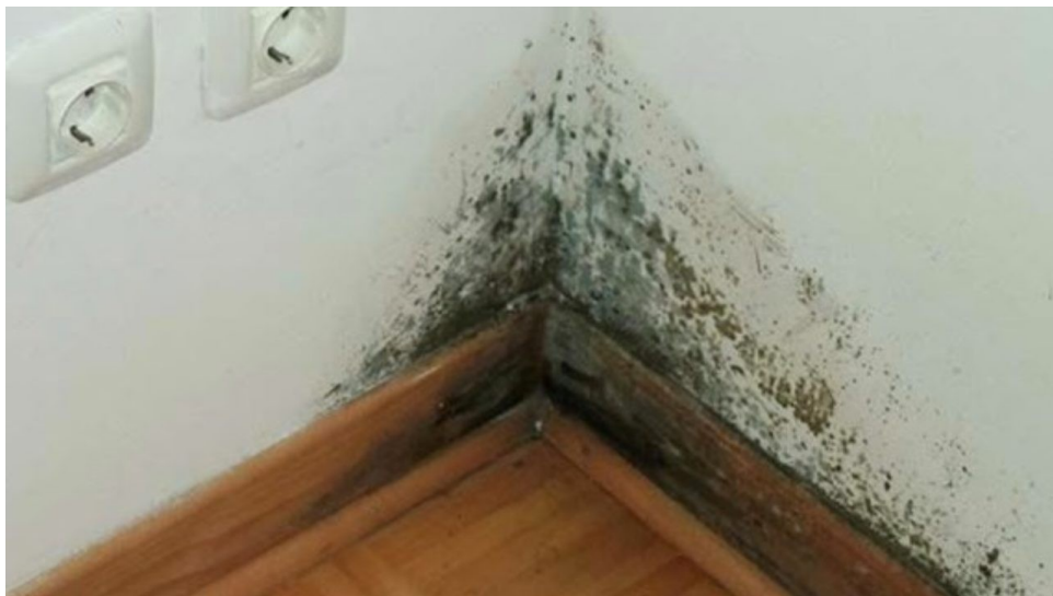
Εικόνα 3α: Φθορά λόγω θερμογεφυρών
