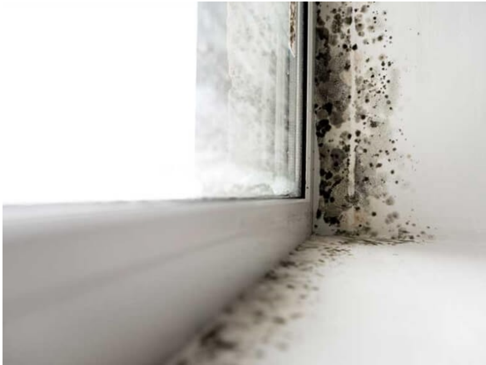
Εικόνα 3: Φθορά από θερμογέφυρα κουφώματος
