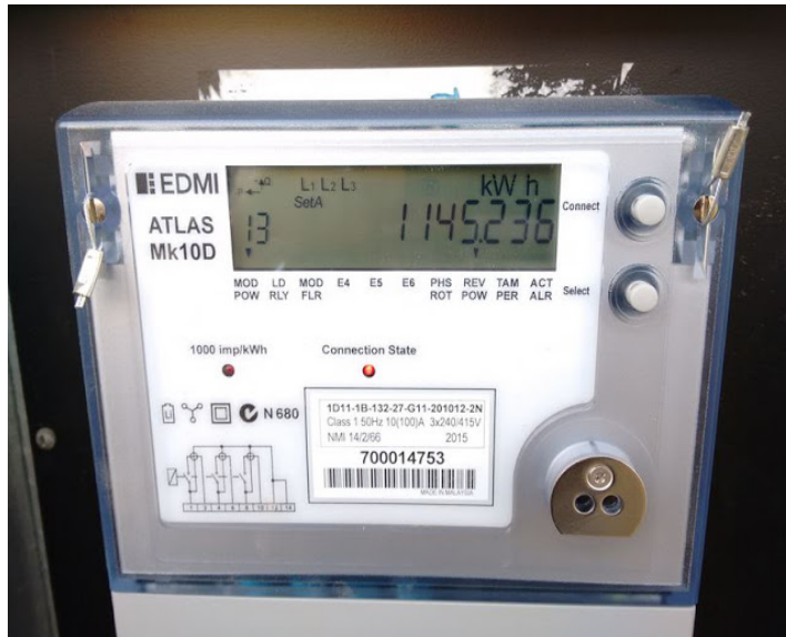
Εικόνα 2.1 Έξυπνος μετρητής ρεύματος
