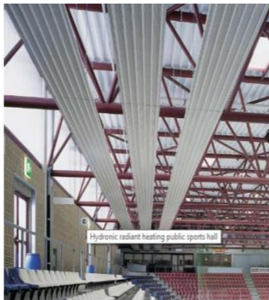
Εικόνα 2-16 Υδραυλικό πάνελ οροφής με παράλληλη ροή για θέρμανση/ψύξη σε αθλητικές εγκαταστάσεις
