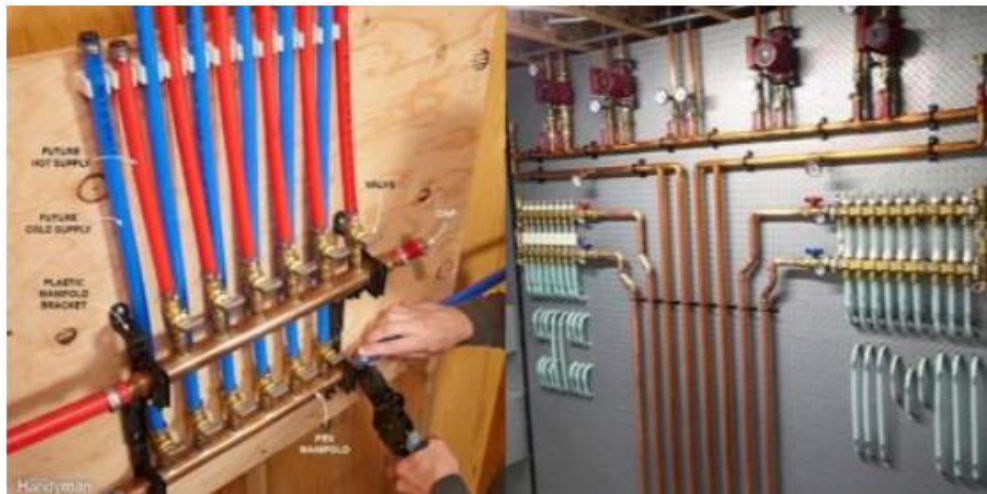
Εικόνα 2-29 Παράδειγμα σωλήνων PEX και σωλήνων χαλκού συνδεδεμένα σε manifolds
