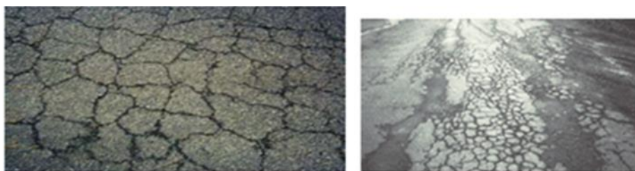
Εικόνα 2.1 «Ρωγμές τύπου αλιγάτορα σε οδόστρωμα»
