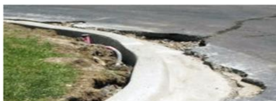
Εικόνα 2.2 «Ρωγμές στα άκρα του οδοστρώματος»
