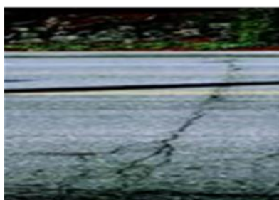
Εικόνα 2.4 «Οι ρωγμές τέτοιου τύπου που πρέπει να καταγράφονται είναι αυτές με μήκος >0,6m»
