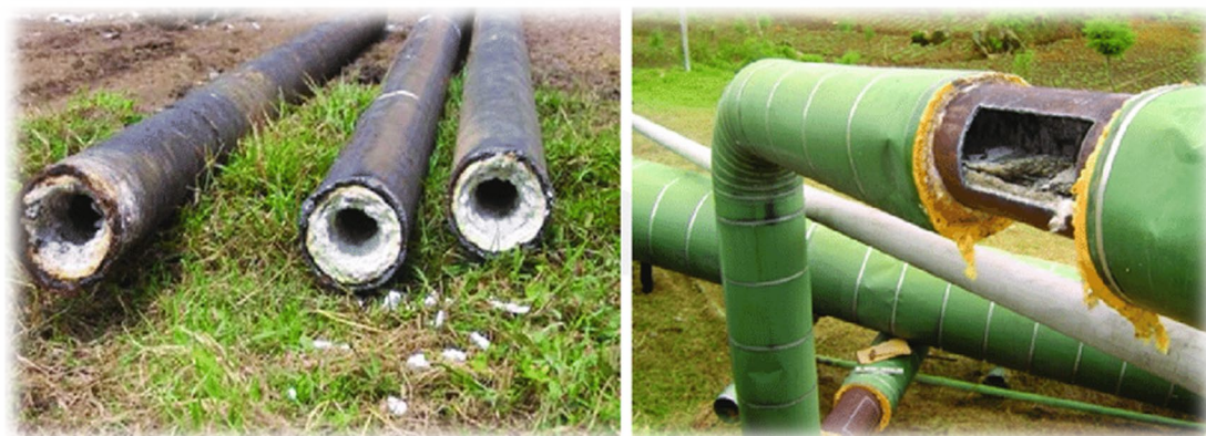
Σχήμα 2.25 - Στρώμα \text{SiO}_2 στο εσωτερικό σωληνώσεων [πηγή: Scale Prevention Technique to Minimize Scaling on Re-injection Pipes, Indonesia]
