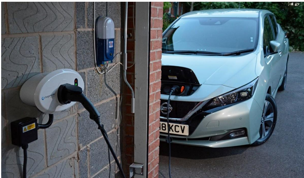
Εικόνα 3.1: Φόρτιση στο σπίτι
