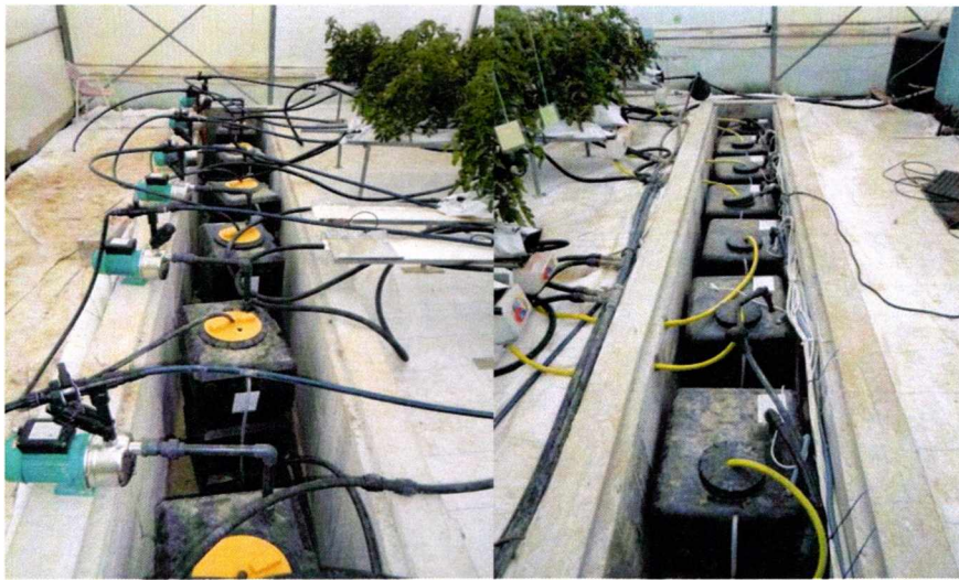
Εικόνα 3.4 : Δεξαμενές άρδευσης (αριστερά) και δεξαμενές απορροής (δεξιά)
