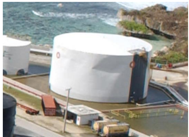
Εικόνα 21 Λυγισμός δεξαμενής στο νησί Γκουάμ, Τυφώνας 2002
