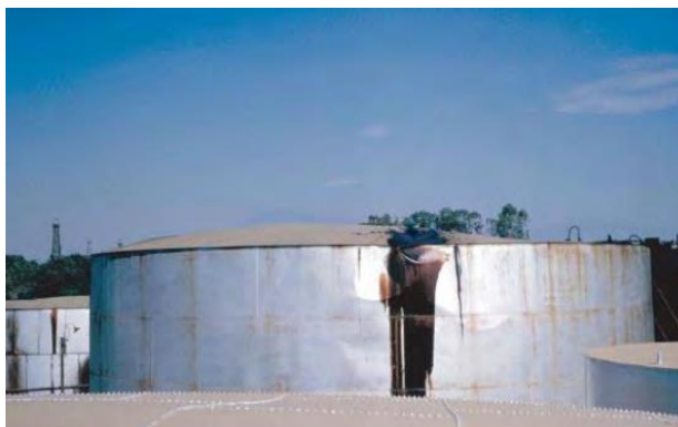
Εικόνα 29 Βλάβη δεξαμενής λόγω κυματισμού του περιεχόμενου ρευστού (Καλιφόρνια)
