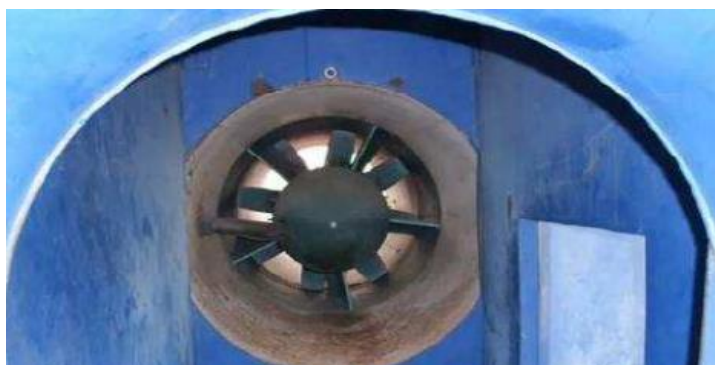
Εικόνα 11 Ανεμιστήρας σε θέση ανοίγματος της δεξαμενής
