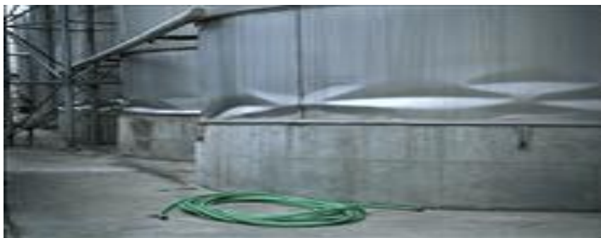
Εικόνα 28 Αστοχία: Diamond buckling
