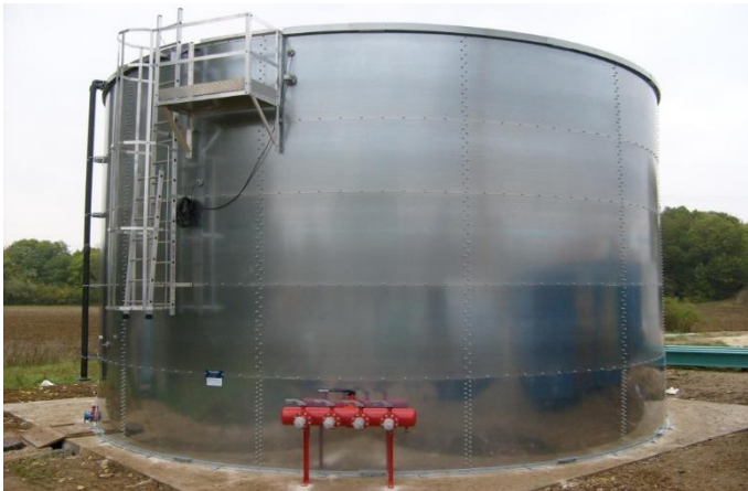
Εικόνα 1 Επίγεια μεταλλική δεξαμενή
