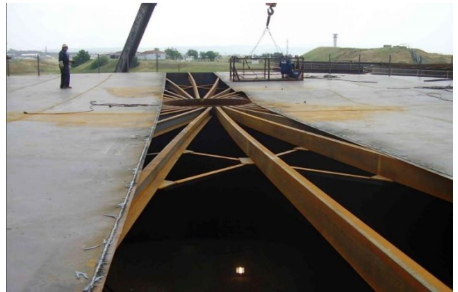
Εικόνα 24 Αστοχία μεταλλικής οροφής εξαιτίας λυγισμού (κάμψη και στρέψη) των δοκαριών στήριξης
