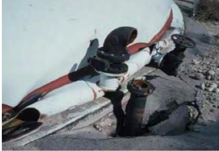
Εικόνα 34 Αστοχία σωληνώσεων μετά απο σεισμό
