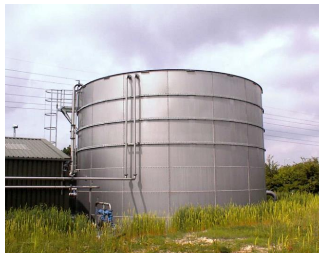
Εικόνα 4 Μεταλλική δεξαμενή με ενισχυτικούς δακτυλίους
