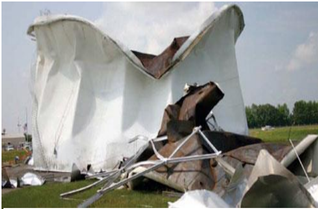
Εικόνα 25 Κατάρρευση δεξαμενής Αρκάνσας 2009
