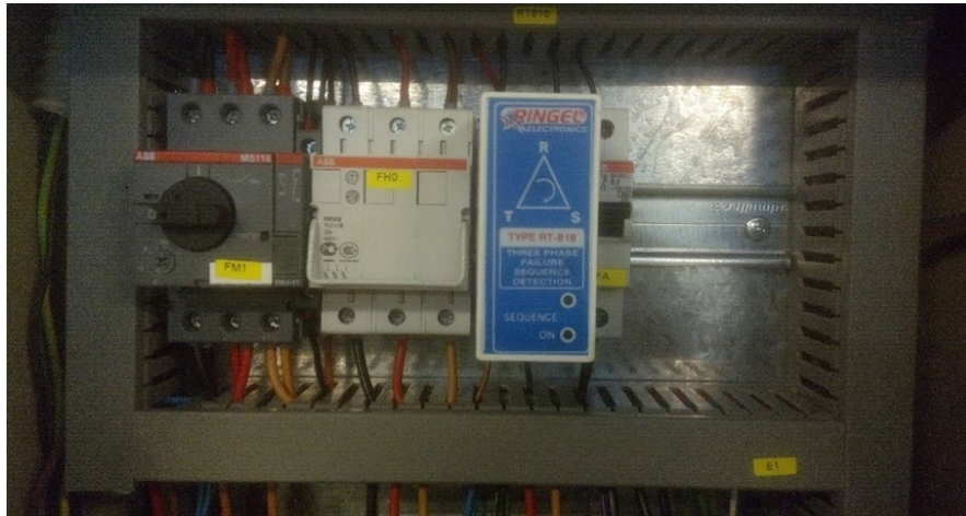
Εικόνα 4.2. Θερμομαγνητικός Διακόπτης, Ασφαλειοαποξεύκτης Φορτίου, Επιτηρητής Τάσης (α)
