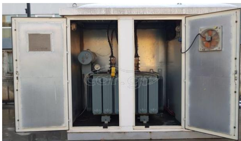
Εικόνα 25: Άποψη υποσταθμού που θα εγκατασταθεί κατά το 3 ο σενάριο (200kWp)
