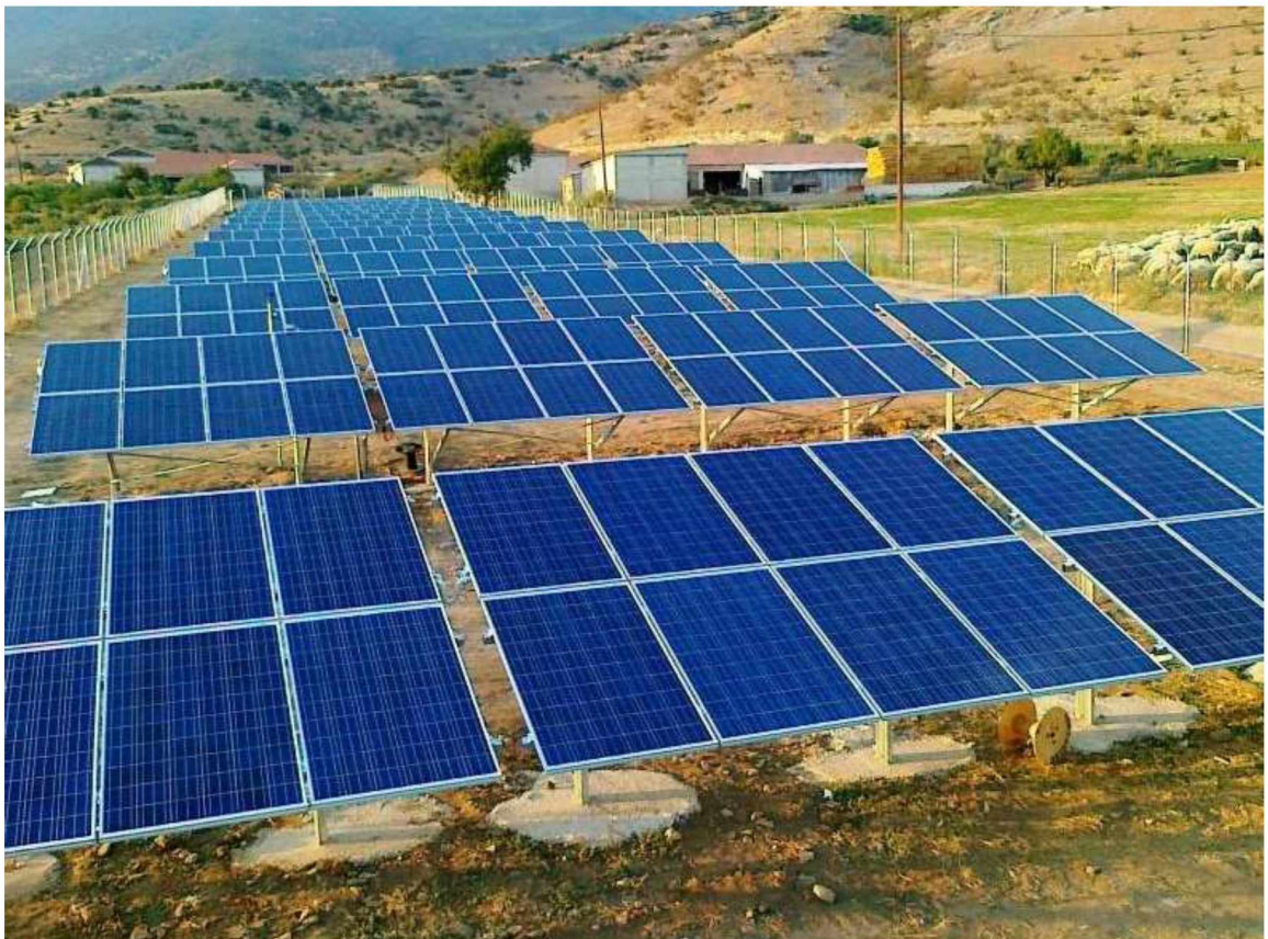
Εικόνα 5.5: Φωτοβολταϊκό πάρκο 100kW στην Αγιά Λάρισας
