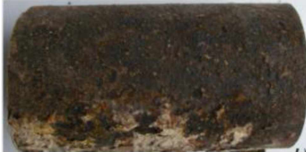
Εικόνα 23: Oil ash corrosion στο σωλήνα του υπερθερμαντήρα του λέβητα. [13]
