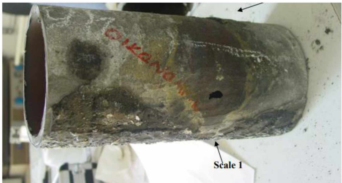
Εικόνα 52: Η επίστρωση με πάχος 2-4.5 mm που έχει σχηματιστεί στην εξωτερική διάμετρο του σωλήνα. [25]
