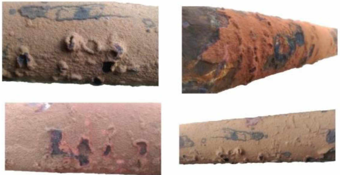
Εικόνα 21: Διάβρωση κάτω από επικαθίσεις στερεών σε λέβητα. [11]
