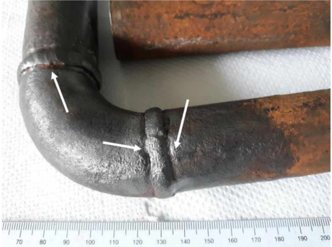
Εικόνα 31: Κοντινότερη όψη της γωνιακής σύνδεσης. Τα βέλη μας υποδεικνύουν την διάβρωση στην περιοχή των συγκολλήσεων. [23]
