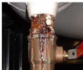
Εικόνα 18: Γαλβανική διάβρωση σε λέβητα. [17]
