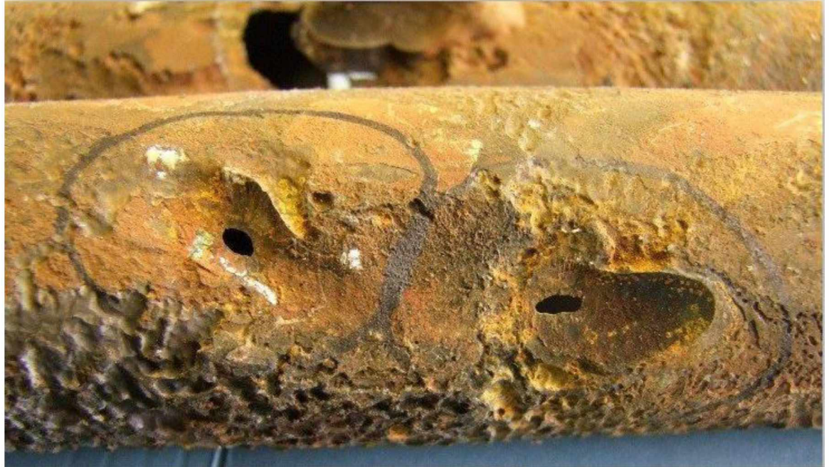
Εικόνα 17: Acidic corrosion στο σωλήνα του λέβητα. [16]
