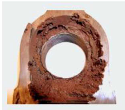
Εικόνα 16: Επίθεση διοξειδίου του άνθρακα σε λέβητα. [15]
