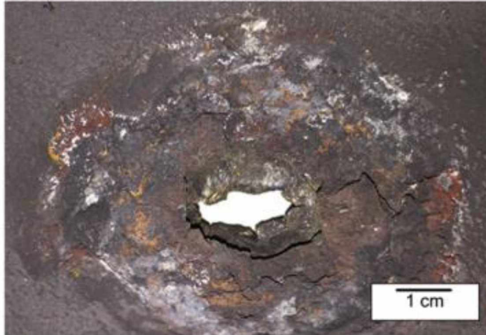
Εικόνα 19: Caustic corrosion στο σωλήνα του λέβητα. [12]
