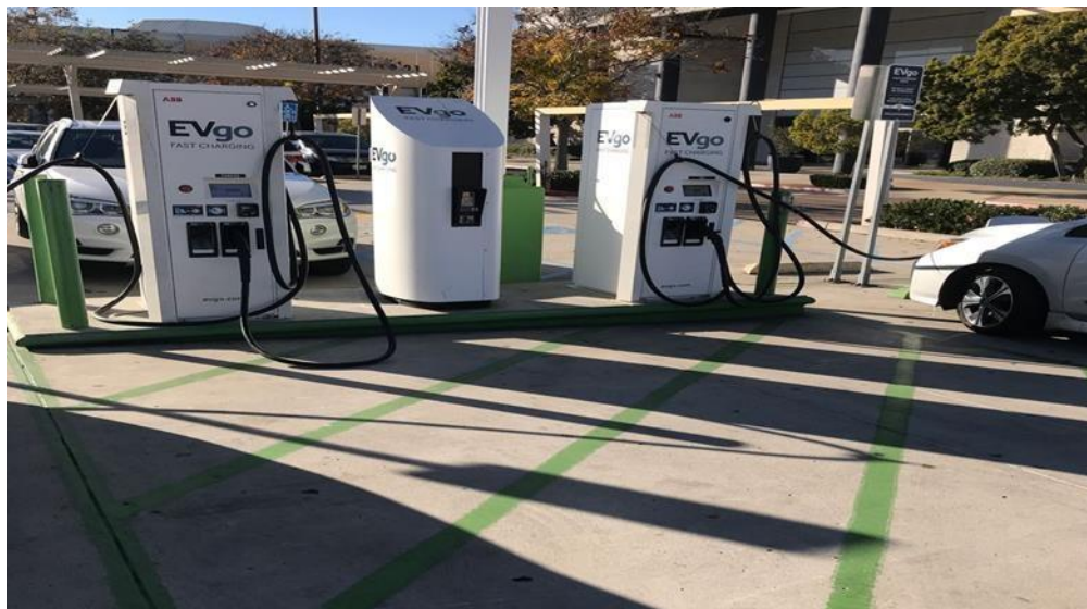
Σχήμα 4-16: Σταθμοί φόρτισης ηλεκτρικών οχημάτων στον λιμένα του San Diego
