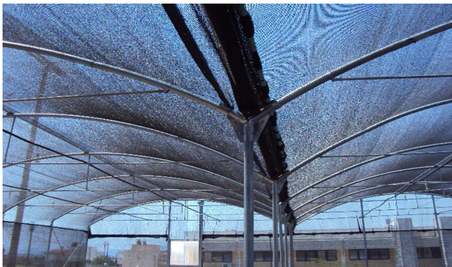
Εικόνα 4 Μεταλλικός γαλβανισμένος σκελετός του διχτοκηπίου του Τμήματος ΓΥΠΠ
