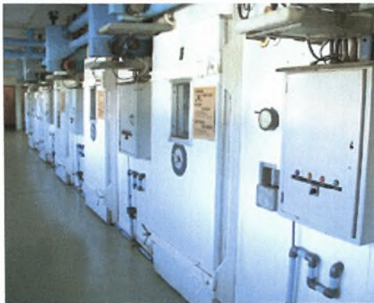
Εικόνα 1: Μονάδα ελεγχόμενης ατμόσφαιρας
