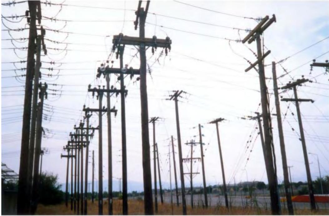
Σχήμα 4.6: Αναχώρηση γραμμών διανομής MT σε υποσταθμό της Κοζάνης [74]
