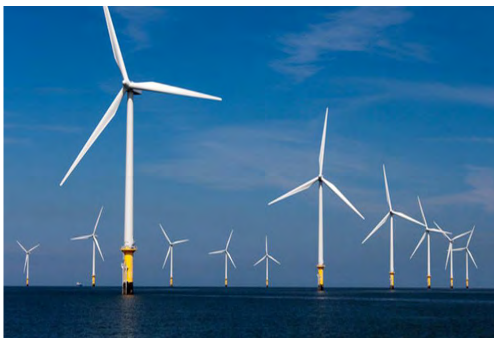
Σχήμα 2.6 Θαλάσσιο αιολικό πάρκο στη Μεγάλη Βρετανία (Energypress).
