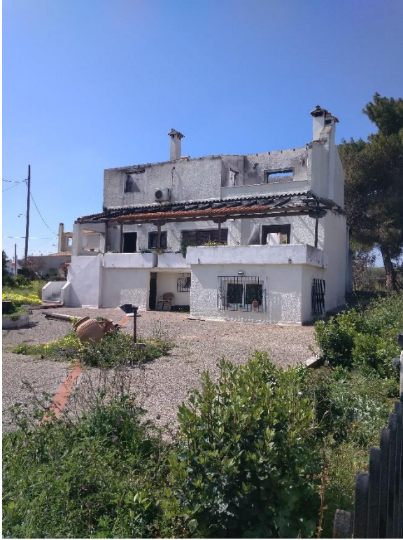
Εικόνα 15: Καμένη κατοικία στο Μάτι
