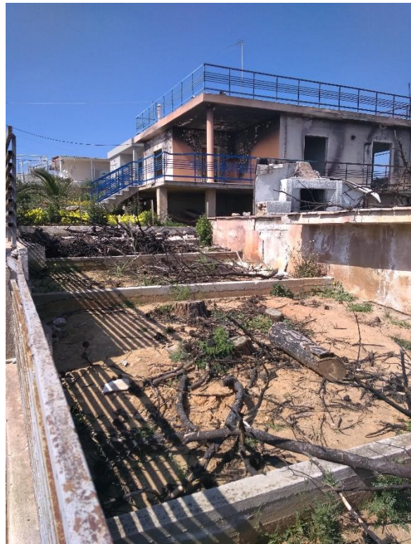
Εικόνα 16: Καμένη κατοικία στο Μάτι
