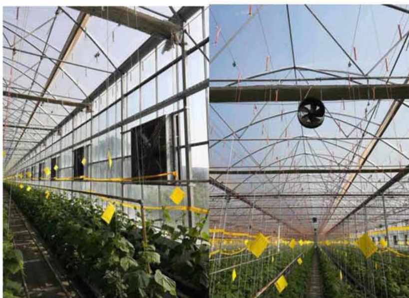
Εικόνα 15. Ανεμιστήρες δυναμικού αερισμού (ανατολική πλευρά θερμοκηπίου) και ανεμιστήρες ανάμειξης του αέρα.
