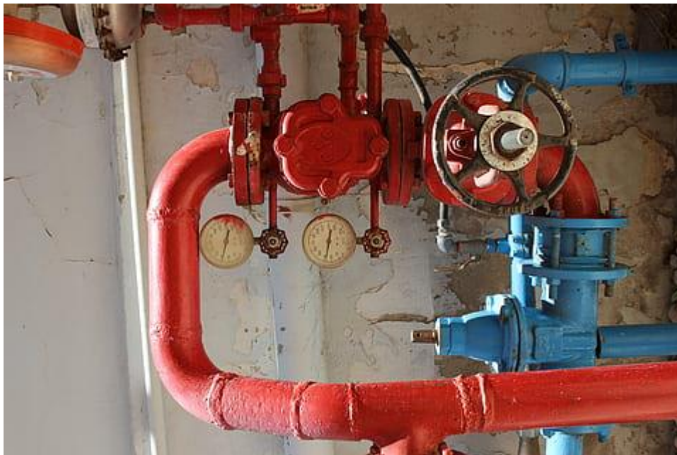
Figure 34: ΒΑΛΒΙΔΑ ΕΛΕΓΧΟΥ ΠΙΕΣΗΣ ΒΙΟΜΗΧΑΝΙΚΟΥ ΜΗΧΑΝΗΜΑΤΟΣ
