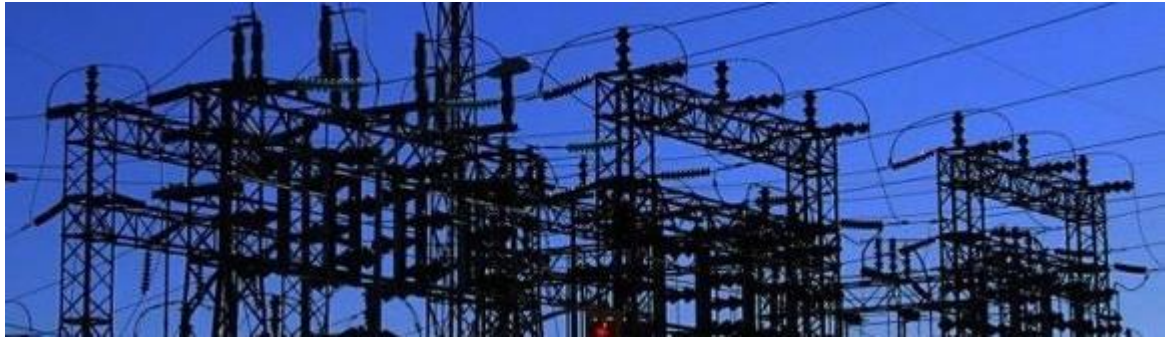
Figure 27: Ηλεκτρικοί πυλώνες υψηλής τάσης
