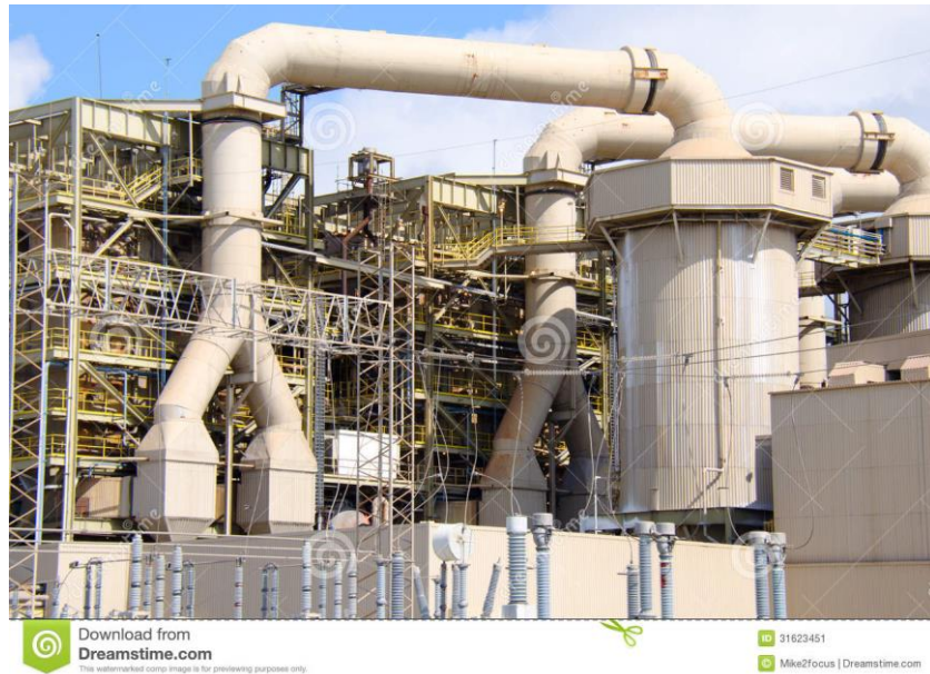
FIGURE 10 ΜΕΓΑΛΕΣ ΕΓΚΑΤΑΣΤΑΣΕΙΣ ΠΑΡΑΓΩΓΗΣ ΕΝΕΡΓΕΙΑΣ.
