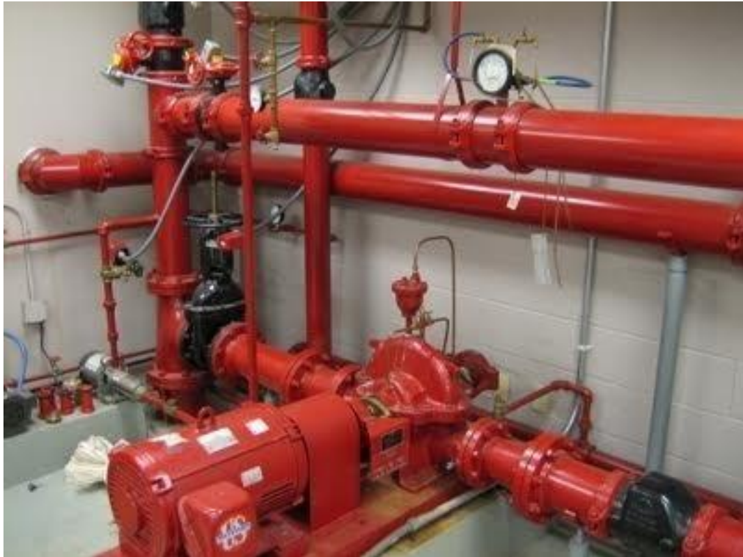
Figure 32: Σύστημα πυρόσβεσης με υδραντλίες.
