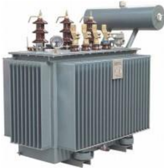
Εικόνα 9: Μετασχηματιστής τύπου ONAN
