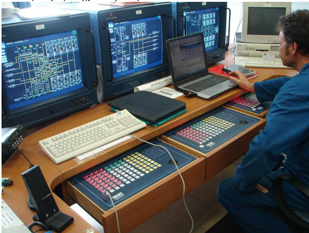
- Cargo Control Room (- Χώρος Ελέγχου Φορτίου)
