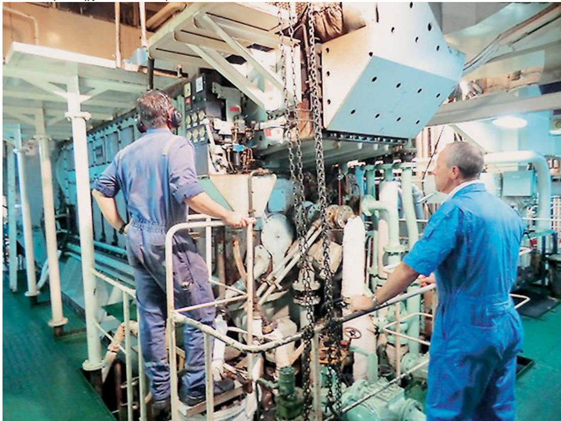
- Engine Room (- Μηχανοστάσιο)
