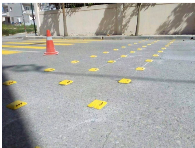
Εικόνα 3.7: Ανακλαστήρες οδοστρώματος σε διάβαση πεζών
