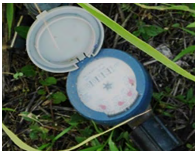
Εικόνα 4.6. Υδρόμετρο τοποθετημένο στον πειραματικό αγρό.
