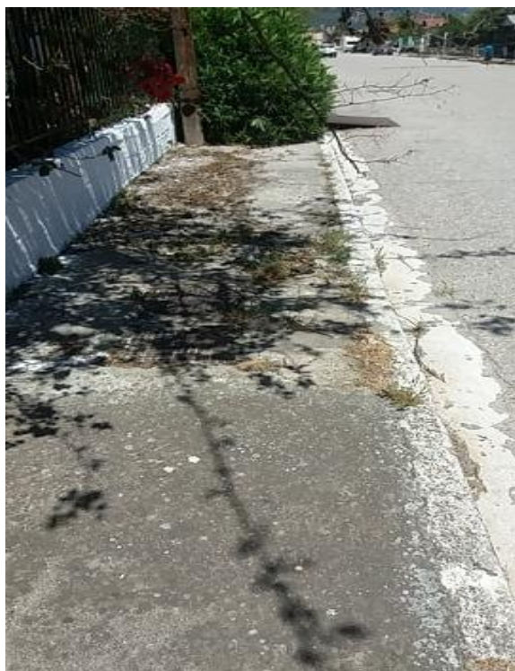
Εικόνα 7.9: Υποχώρηση υλικών επίστρωσης πεζοδρομίων
