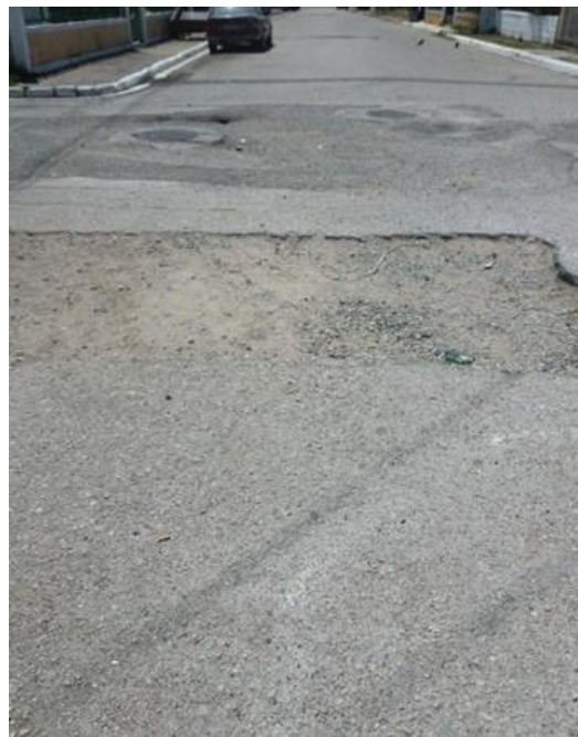
Εικόνα 7.6: Φθορά οδικού δικτύου της περιοχής
