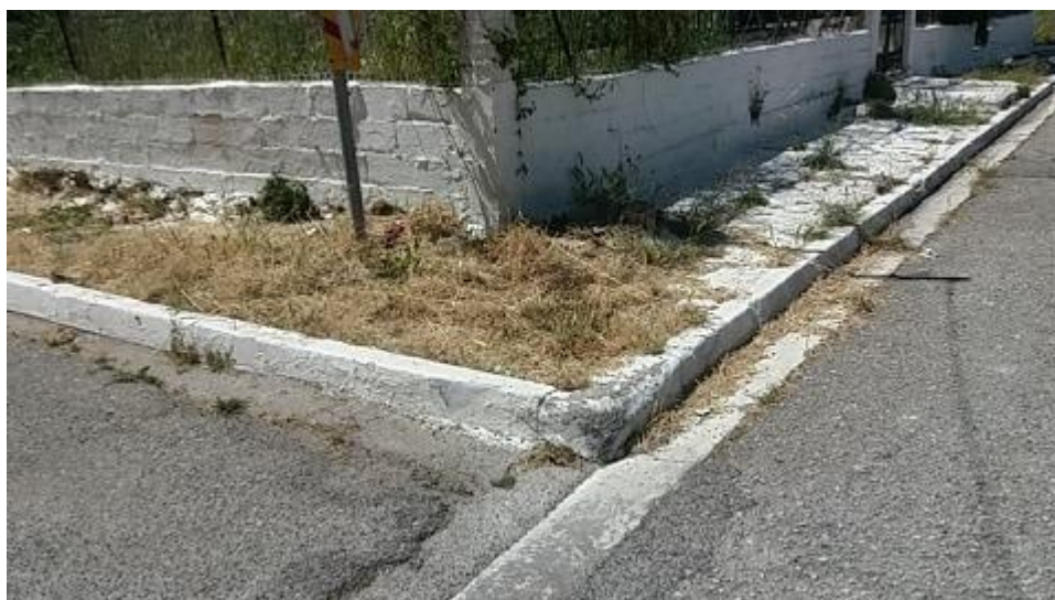
Εικόνα 7.7: Υποχώρηση υλικών επίστρωσης πεζοδρομίων
