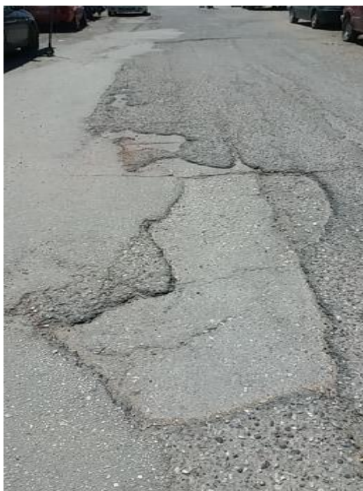
Εικόνα 7.5: Φθορά οδικού δικτύου της περιοχής
