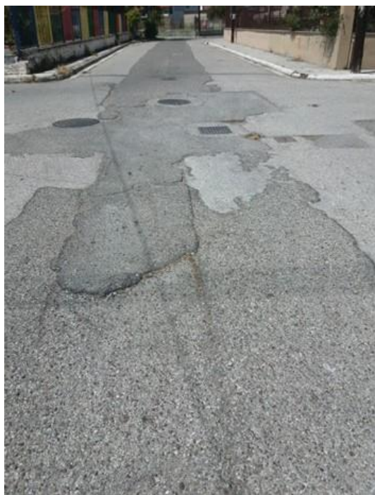
Εικόνα 7.3: Φθορά οδικού δικτύου της περιοχής
