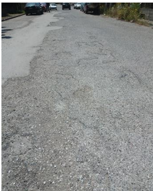
Εικόνα 7.4: Φθορά οδικού δικτύου της περιοχής
