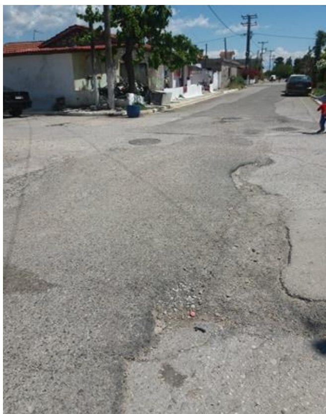
Εικόνα 7.2: Φθορά οδικού δικτύου της περιοχής
