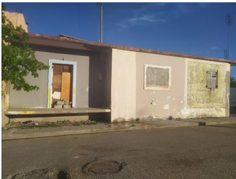
Εικόνα 7.16: Κατοικία Ρομά σε κακή κτηριακή κατάσταση
