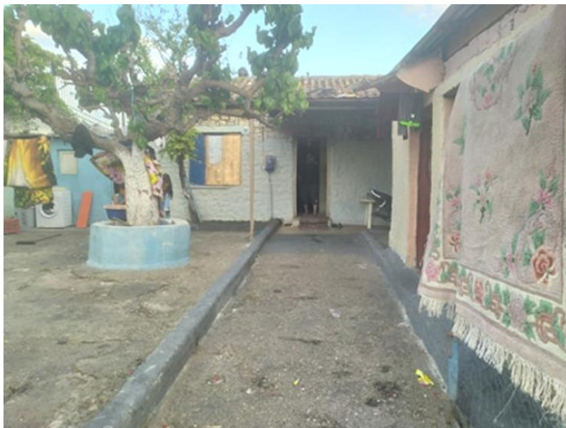
Εικόνα 7.15: Κατοικία σε κακή κτηριακή κατάσταση
